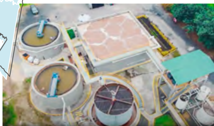
Planta de tratamiento de agua residual Alqueria Cajicá, Cundinamarca, Colombia
