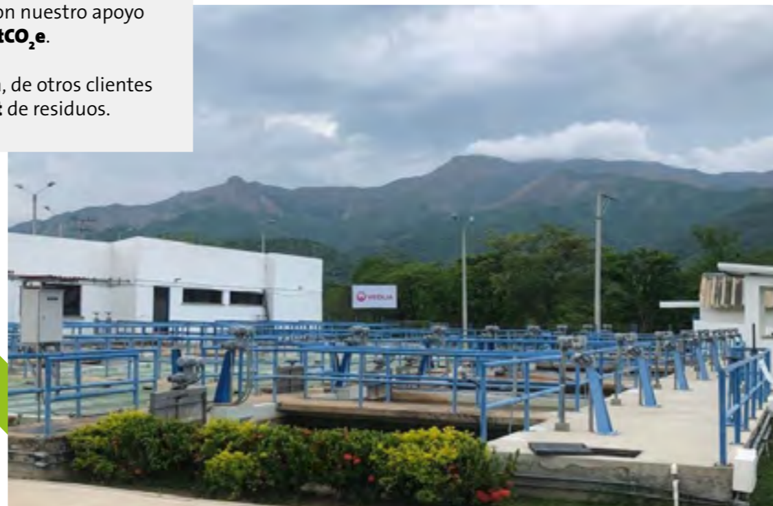
Planta de tratamiento de agua potable Metesusto Metesusto, Guajira, Colombia
