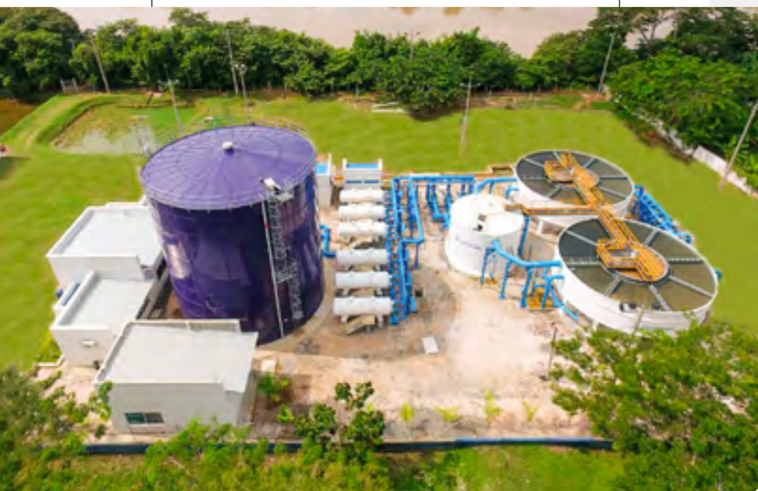
Planta de tratamiento de agua potable Iguanas Veolia Aguas de Montería Montería, Córdoba. Colombia
